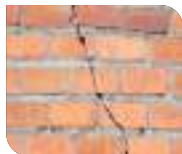
Trinca em alvenaria.
